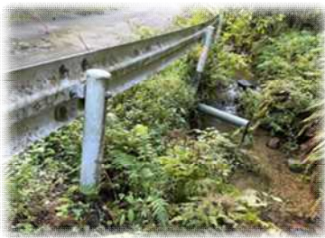
現場状況 (雨水等により保護路肩に浸食発生)
