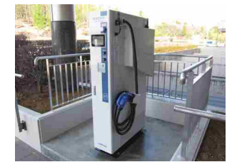
本庁舎西通口近くに設置した 電気自動車急速充電器
