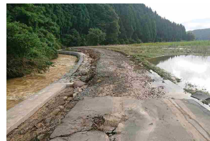
道路の被害状況
