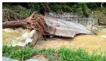
農業施設(頭首工)破損
