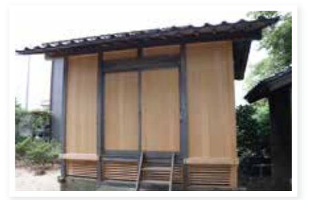
今年の4月の落雷により破損した収納小屋の新しい外壁には、温かみのある色の木材が使用されており、きれいに様変わりしていました。
