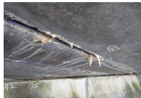
コンクリート橋床版の漏水・錆汁
