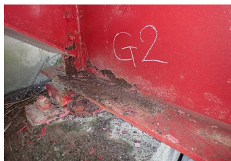
鋼橋桁・支承の腐食
