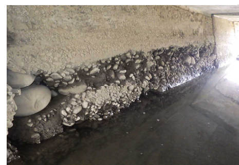
コンクリート橋台の洗掘・断面欠損
