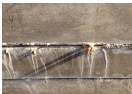
橋桁下面の漏水・白色析出物
