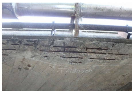
コンクリート橋桁の剥離・鉄筋露出
