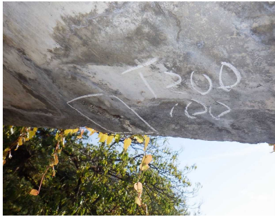
頂版コンクリートの鉄筋露出
