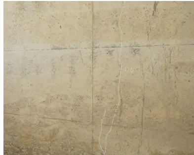
側壁コンクリートのひび割れ
