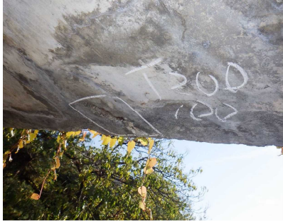
頂版コンクリートの鉄筋露出
