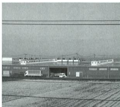
▲屋根一面に敷き詰められた太陽光パネル
