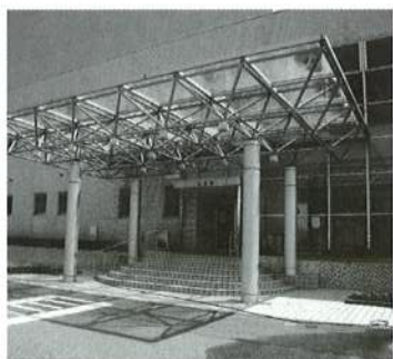
▲スロープと自動ドアの設置が求められる(文化会館北側玄関)
