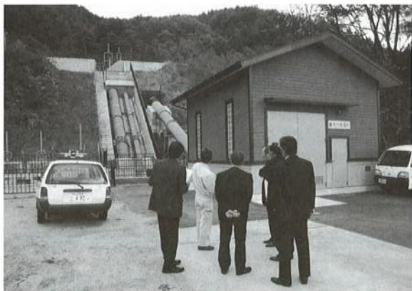
▲小水力発電施設の町川発電所（長野県大町市）
