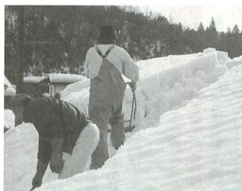
▲補助制度を活用（大変な屋根雪おろし：長滝町）
